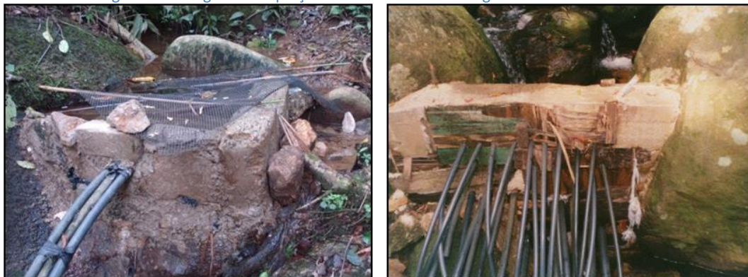
Figura 10 - Imagens de captações alternativas com mangueiras na UGRHI 03.
