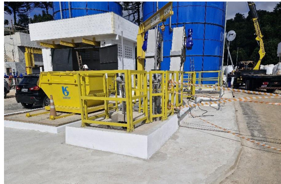
Canal do gradeamento (gradeamento mecanizado e rosca transportadora)
