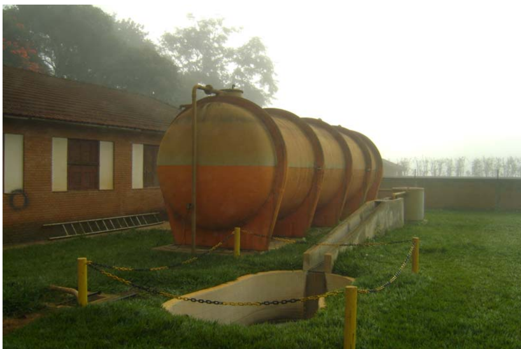
Figura 06: Estação de Tratamento de Esgoto
