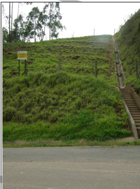
Foto VI.3.2.1-2 – Outro exemplo funcional de obras para controle de erosão. Canaletas longitudinais e transversais com escada de dissipação na base do talude. Coordenada 367419E / 7444860N.
