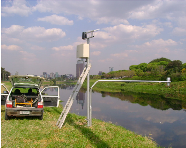
PCD em poste alto com sensor de nível ultrassom
